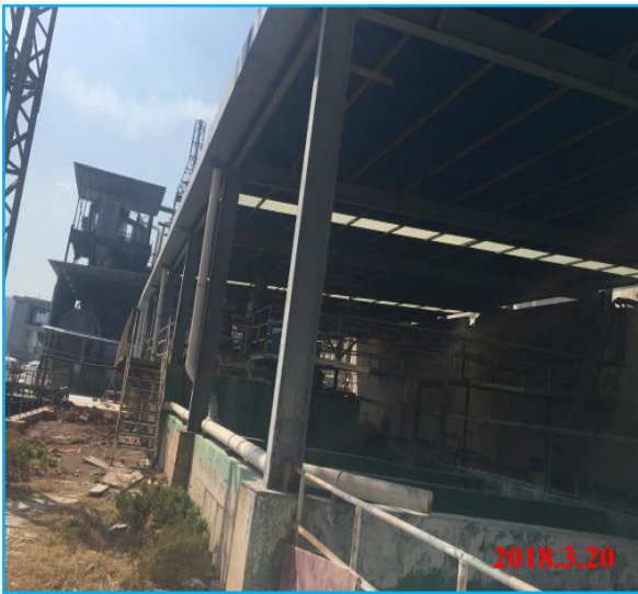
项目东侧雨水管网
