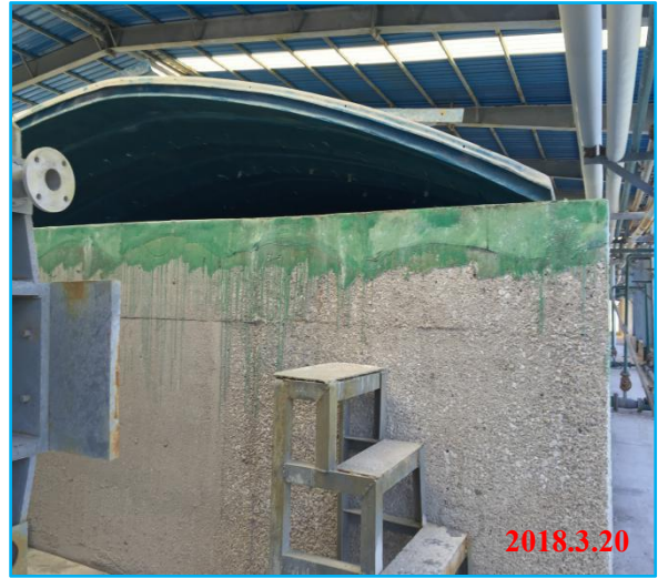
加盖氟硅酸池
