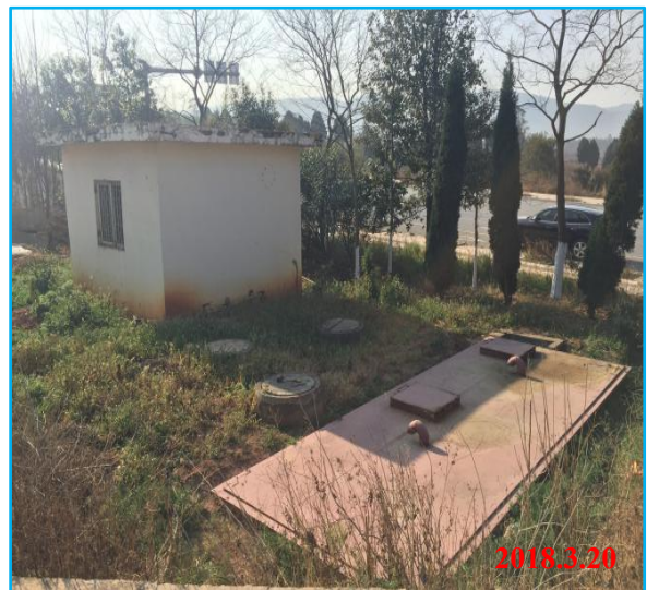
生活污水处理站
