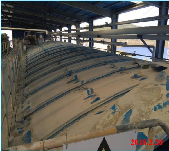
加盖氟硅酸池
